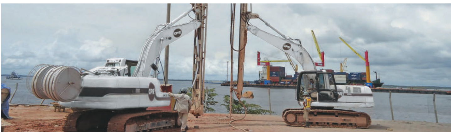
Áreas portuárias com desnivelamento do pavimento são automaticamente corrigidas após o tratamento do solo.
