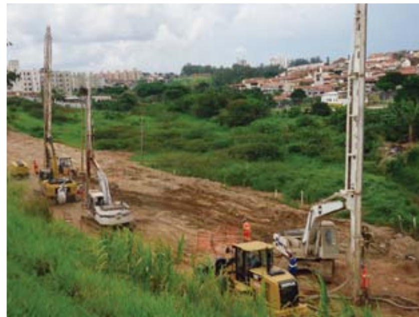
O CPR Grouting sendo executado no trecho 2. Todas as futuras marginais passavam sobre depósitos de solos moles e uma, em especial, sobre um gasoduto. A solução foi o CPR Grouting.
