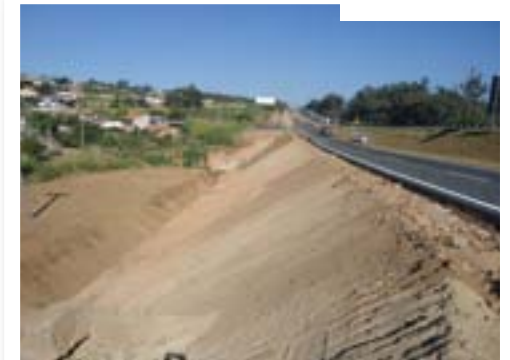
Obra quase entregue no trecho 3, com altura de aterro de 10m. O gasoduto de 800mm de diâmetro passa junto e paralelo ao pé do aterro.
