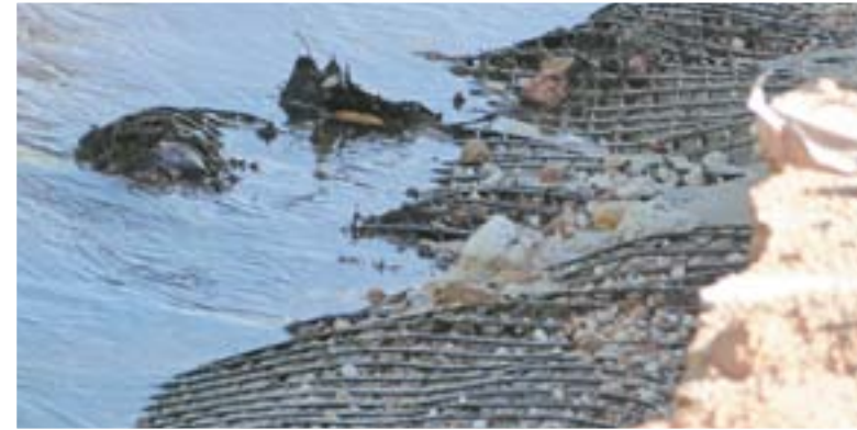
O enrijecimento feito com duas camadas de geogrelha, para receber 2m de aterro e base do pavimento, não foi suficiente, sucumbindo rapidamente ao solo mole pertinente às lagoas da região. Trechos de estradas prontos e com execução apenas de aterros afundaram rapidamente. O CPR Grouting foi a solução para este problema.
