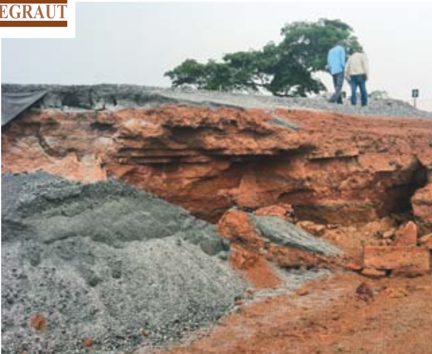
A ruptura do novo talude, devido a elevação do greide, ao lado da estrada original. Presença de solo mole.
