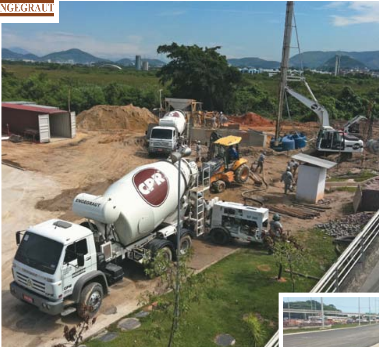
A formação de verticais de adensamento ao longo da duplicação da avenida Ayrton Senna.
