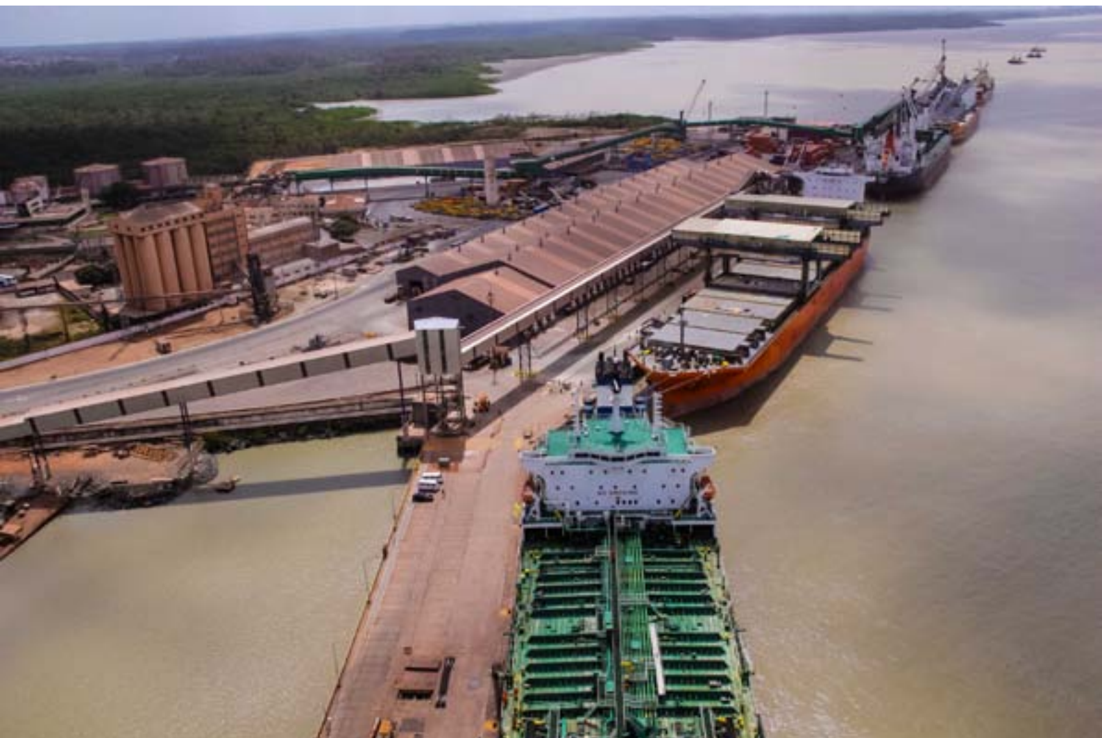
Porto do Itaqui, São Luís, MA. Serviços de CPR Grouting para acesso da ferrovia ao cais.
