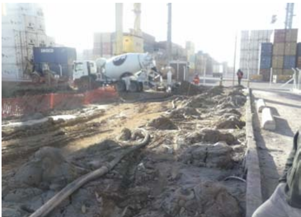
Enrijecimento do solo de fundação com CPR Grouting na retroárea do Porto de Navegantes, SC.
