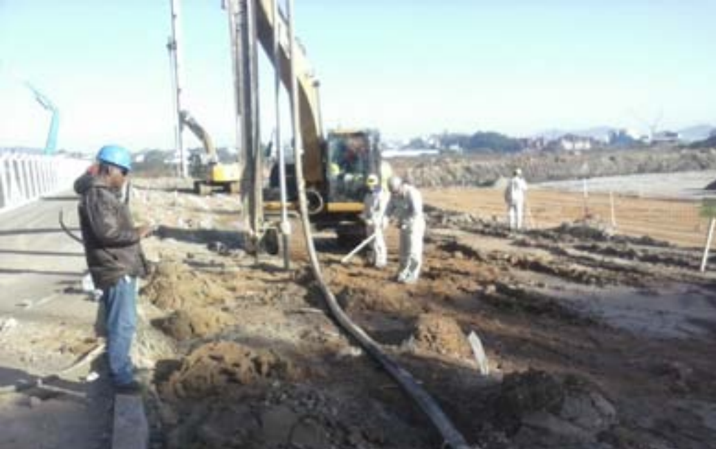
O controle de qualidade dos serviços, junto as estacas do cais, foi feito com a instalação de inclinômetros
